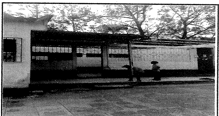
Foto 4: visualización durante se realiza la instalación de lámina troquelada en aula y corredor
